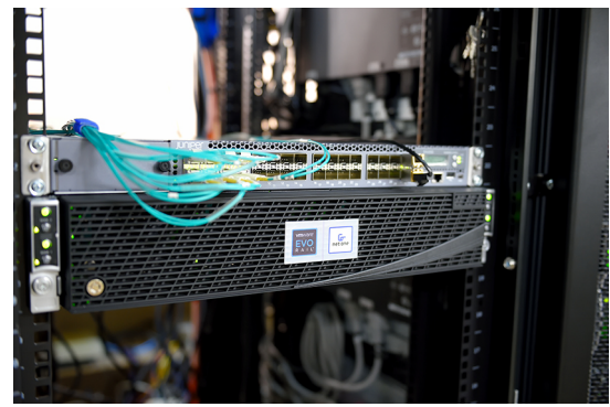
ラックに格納され、サーバ室で本番稼働するEVO:RAIL
